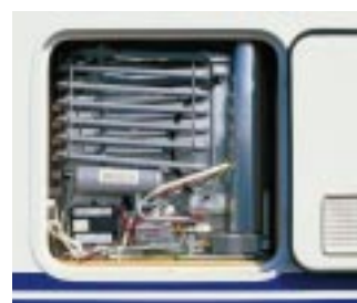
Luxuriös: Wartungsklappe für den Kühlschrank (oben), Waschraum mit Häcksel-Yacht-Toilette (links).
